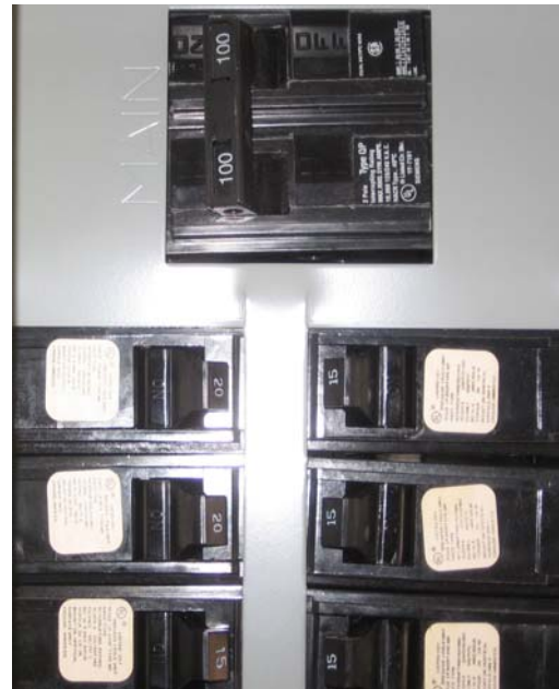
Actual Picture Of Panel
