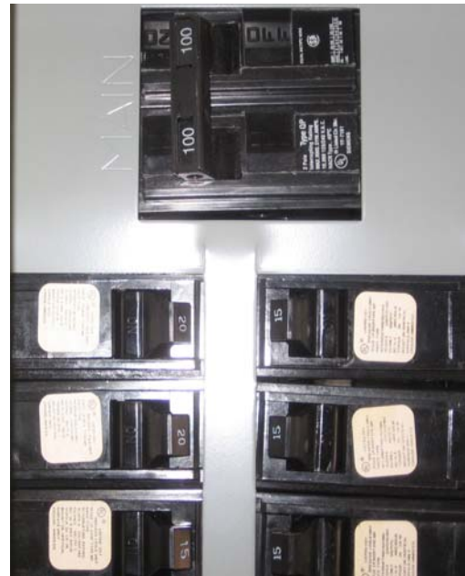
Actual Picture Of Panel
